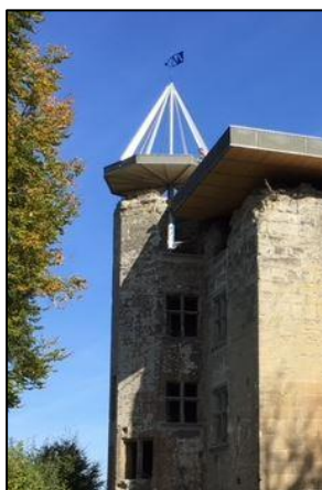
La tourelle avec sa couverture de protection et sa coiffe
